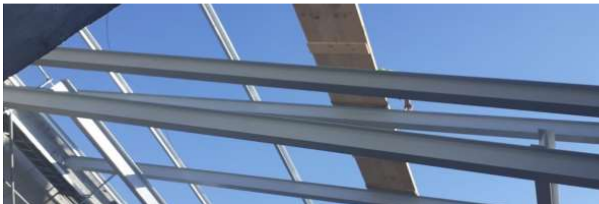
Fot. Niewłaściwy sposób organizacji i dojścia do stanowiska pracy na wysokości
