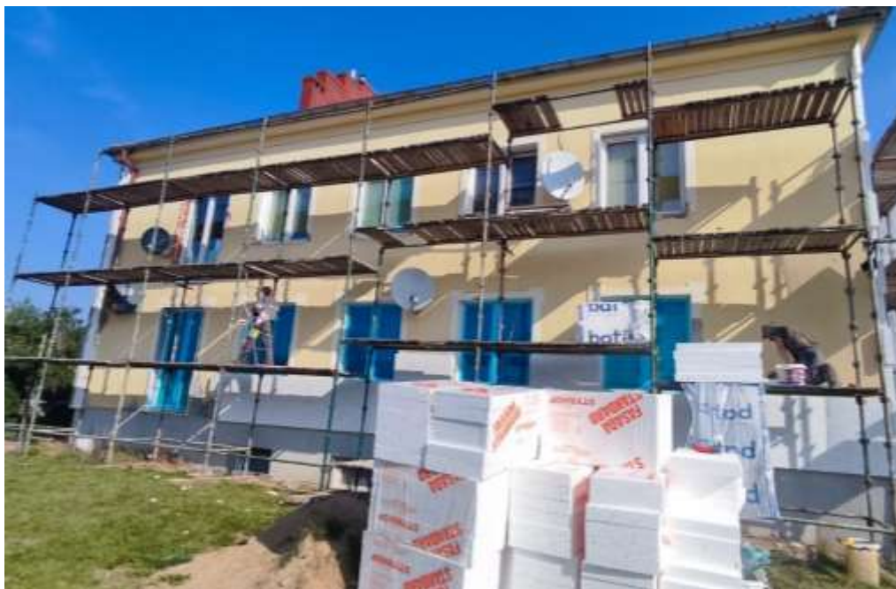
Fot. Nieprawidłowe wykonane rusztowanie
