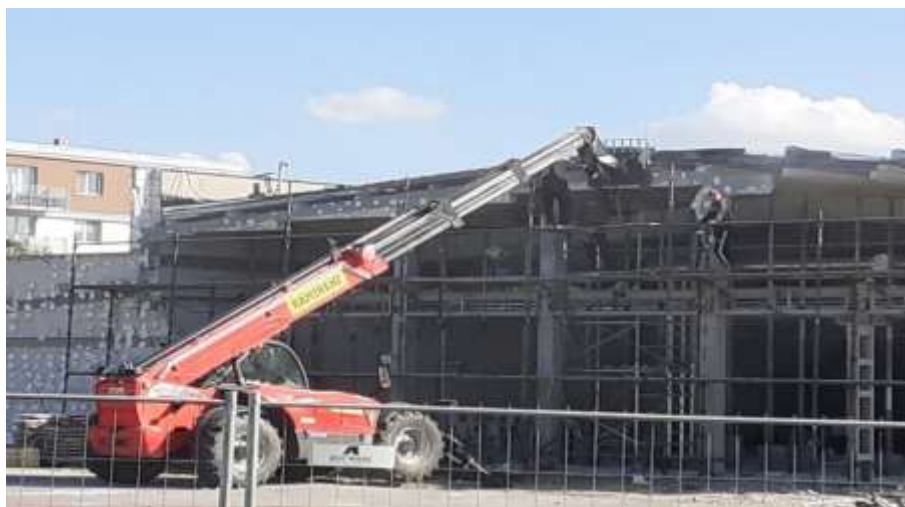
Fot. Przedstawia wykonywanie prac na wysokości bez środków ochrony indywidualnej, wykorzystania rusztowania bez balustrad.
