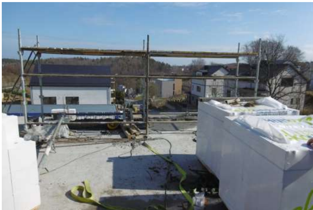
Na fotografii widać rusztowanie na stropie ponad parterem – w miejscu, gdzie wcześniej stali poszkodowani oraz widać leżącą „sztycę” i pas - użyte do stabilizowania szalunku.
