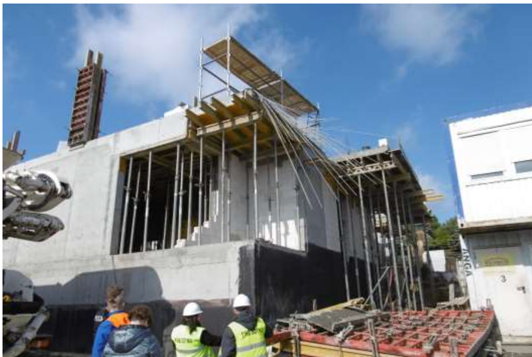
Na fotografii widać miejsce wypadku z szalunkiem leżącym na ziemi oraz rusztowaniem stojącym na stropie ponad parterem (wysokość 5 metrów ponad ziemią), na którym wcześniej stali uszkodzeni pracownicy.
