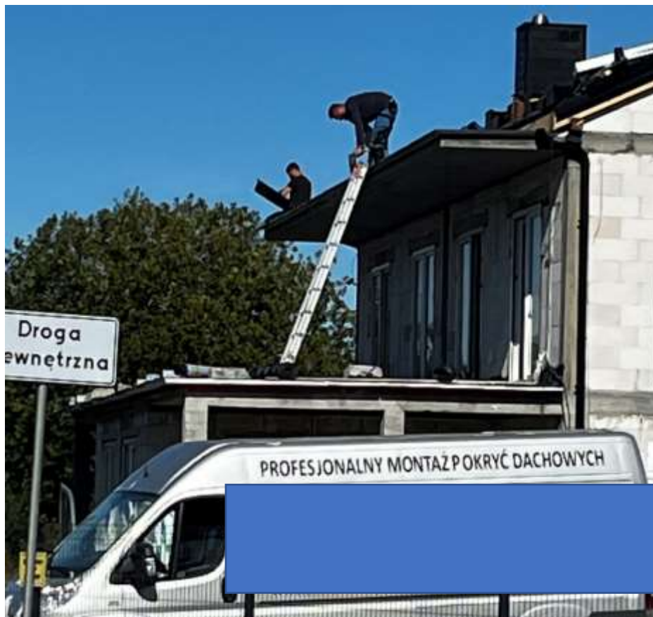
Fot. Przedstawia pracę na wysokości bez zabezpieczeń zbiorowych oraz środków ochrony indywidualnej.
