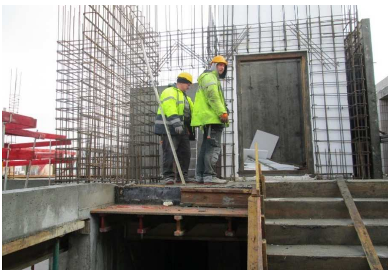
Praca przy krawędzi stropu - brak zabezpieczenia pracowników przed upadkiem z wysokości.
