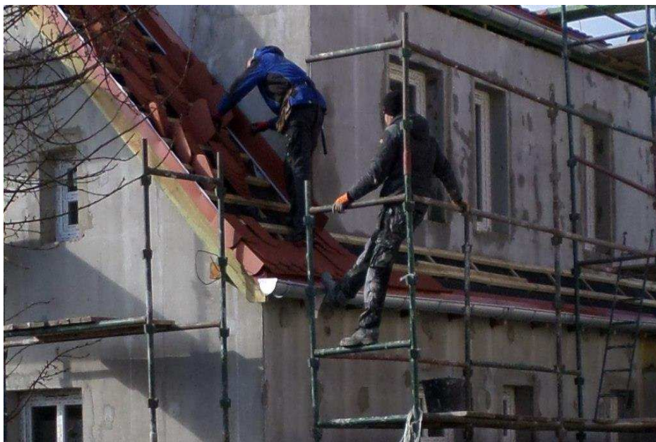
Nieprawidłowe rusztowanie: brak balustrad, pełnych pomostów i kotwienia. Pracownicy nie używają hełmów ochronnych.
