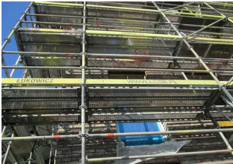
Pomiędzy pomostami rusztowania i ścianami budynku zamontowano dodatkowe wąskie pomosty, zmniejszające odległość pomostów od ściany.
