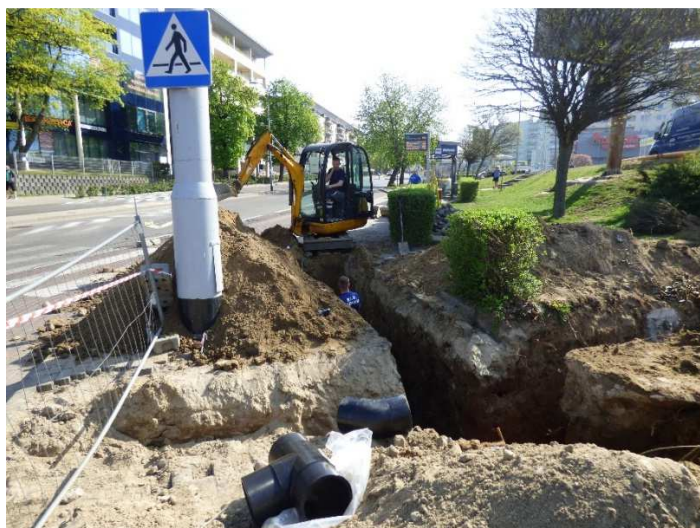
Niezabezpieczone ściany wykopu przed możliwością osunięcia się gruntu, nieużytkowanie przez pracownika hełmu ochronnego, nieprawidłowe składowanie urobku
