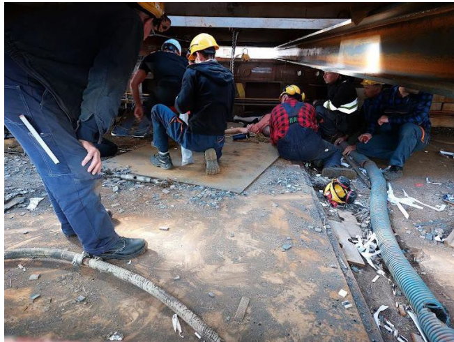
Powyższe zdjęcie obrazuje miejsce wypadku. Na zdjęciu widoczna jest blacha stalowa, a w głębi uchwyt magnetyczny i ściągacz łańcuchowy, którym była pozycjonowana blacha.
